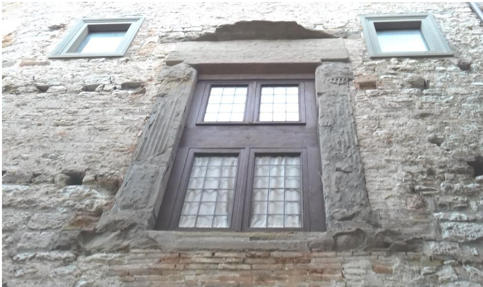
Fig.14 Fotografia esterna della finestra principale e delle due piccole finestre laterali dello studiolo
