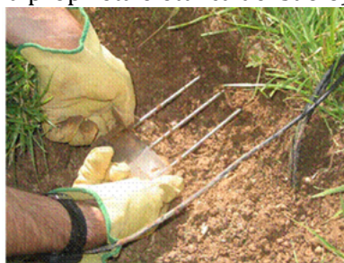
Installazione di una sonda di umidità di tipo TDR (Time Domain Reflectometry)
