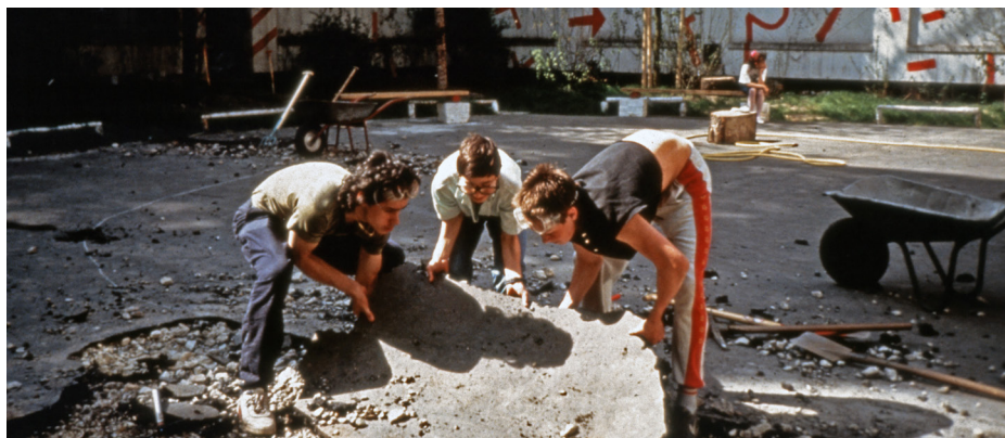
Foto 1 - Primi lavori con l'aiuto dei ragazzi: scarificazione dell'asfalto per rendere permeabile il terreno (ph Coenen, Gruen macht Schole)
